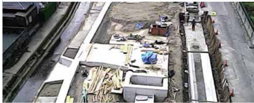
[上]千坊雨水ポンプ場 [下]問田雨水ポンプ場
