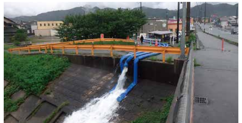
令和5年7月9日 問田川への排水
